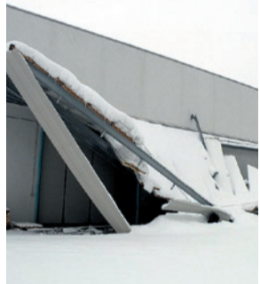
La tettoia crollata del magazzino carico/scarico della Si.Fer Srl di Castelfidardo
